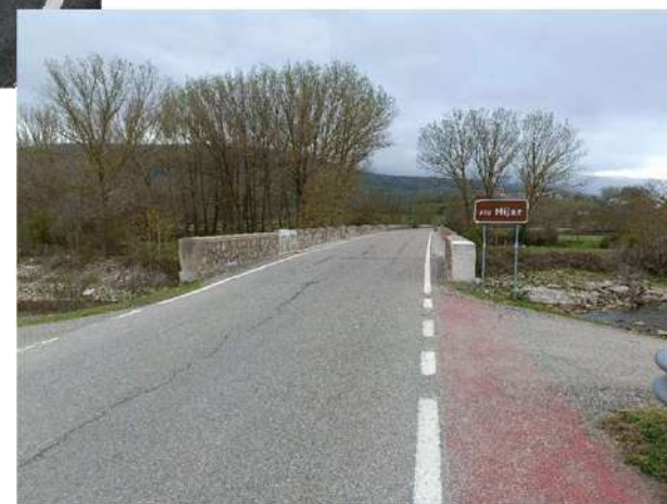
Puente Río Hija. Precaución, doble sentido.
